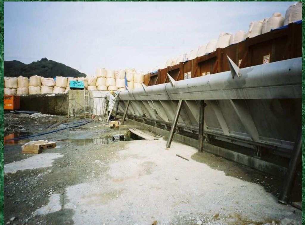
写7-2 扉体サポート
