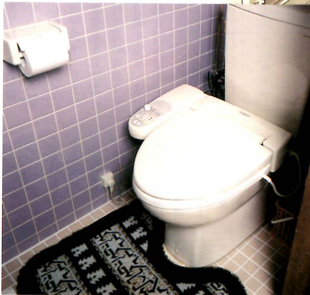
▲ 水洗化されたトイレ
